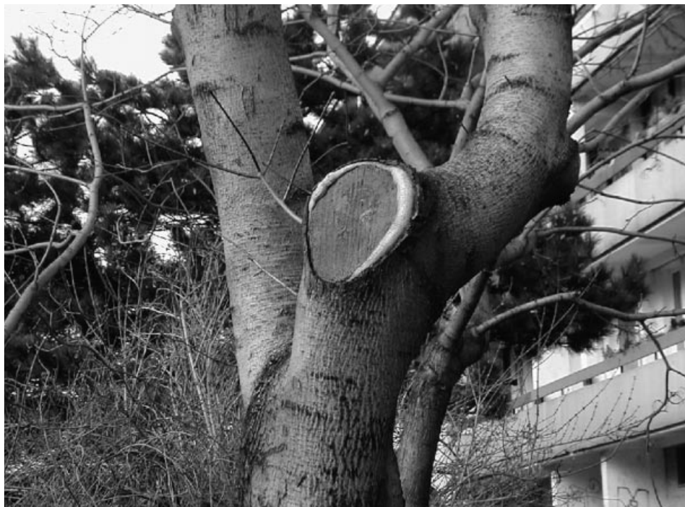
Obr. 3: Jav s ktorým sa, bohužiaľ, často stretávame. Nesprávne vedený rez kostrového konára s priemerom 25 cm! (foto: archív autorky)
